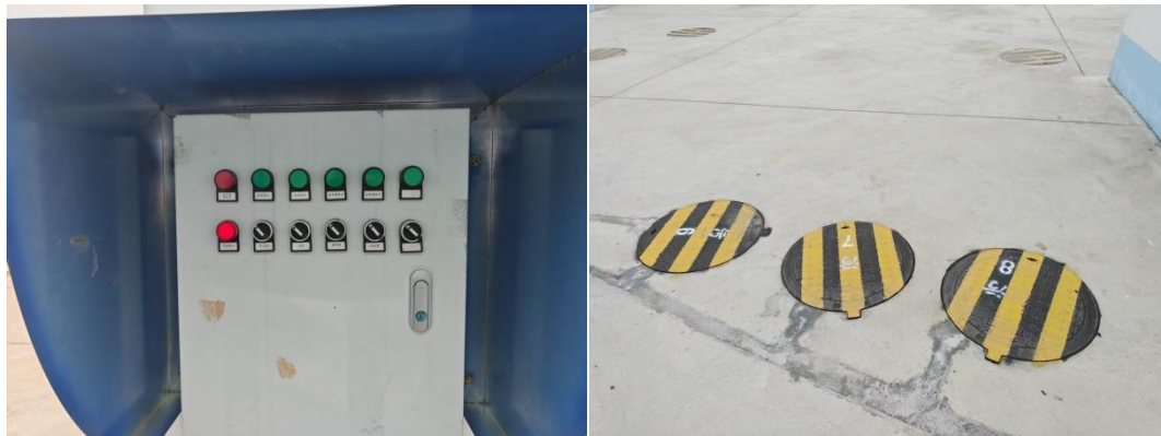
图 5-2 升压站一体式污水处理设备
