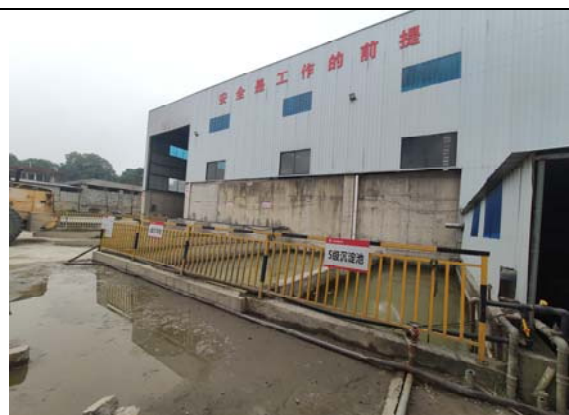
生产区泥沙沉淀池
