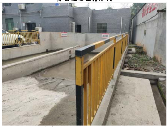
东南侧排水出口三级沉沙池
