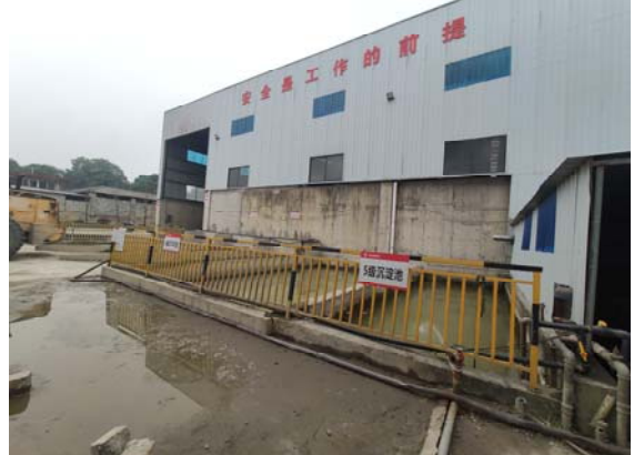
生产区泥沙沉淀池
