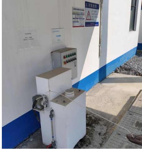
图 5-2 升压站一体式污水处理设备
