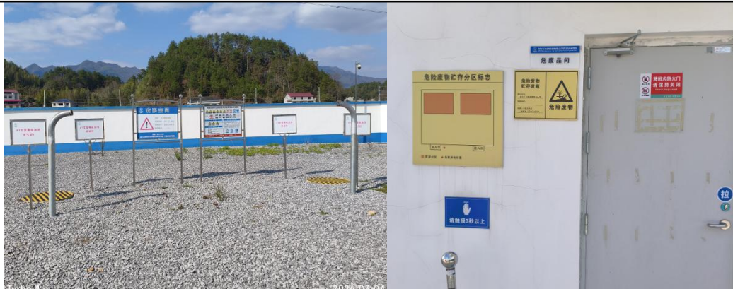
图 5-3 升压站事故油池和危废暂存间
