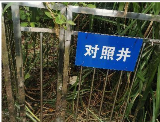
地下水对照井
