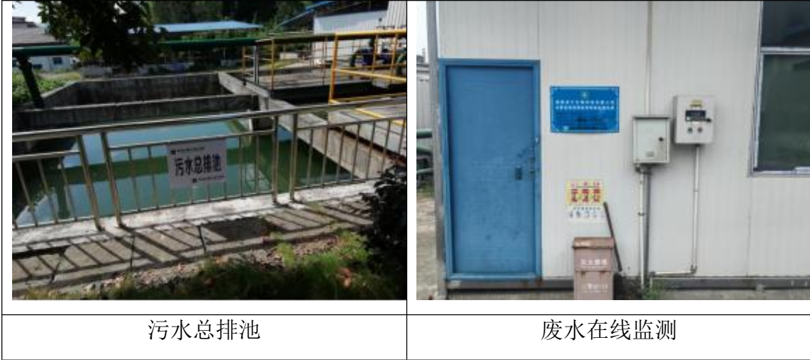
图 2.4.2-1 废水处理设施照片
