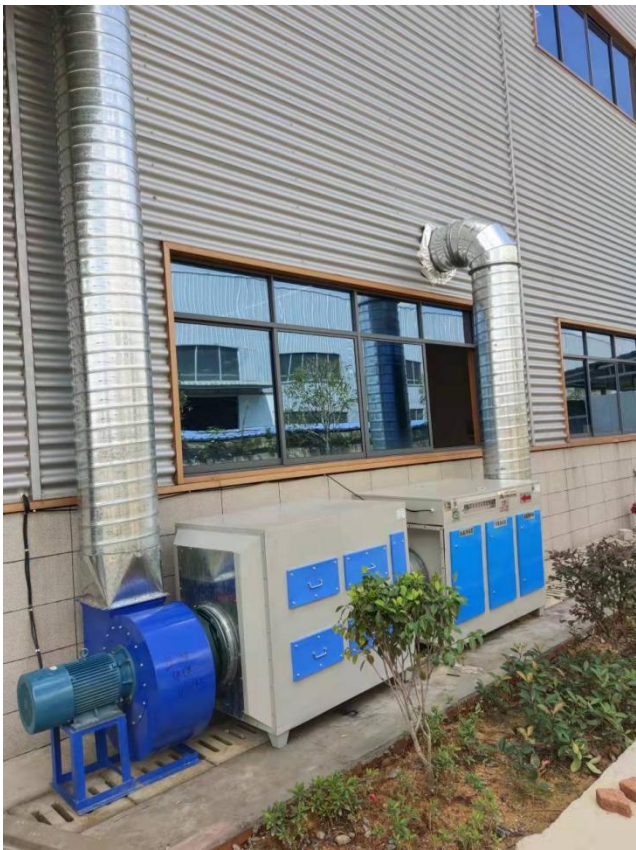
废气处理设备
