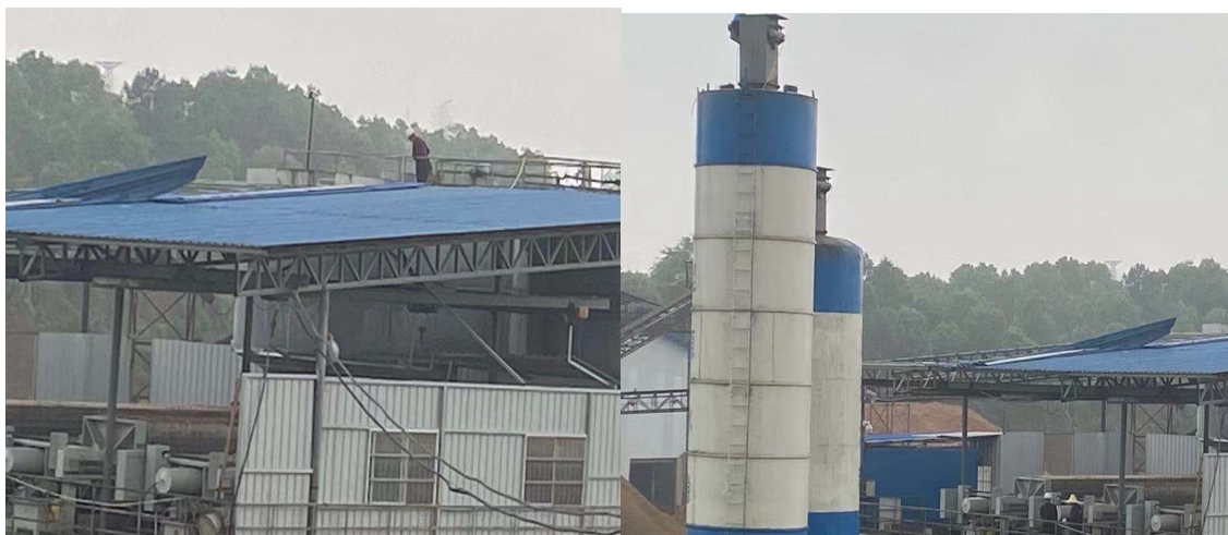
图 4.1-2 三氢净化体现场照片
