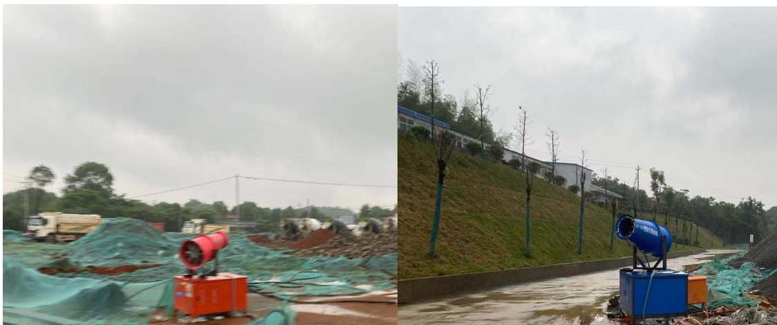
图 4.1-3 项目厂区抑尘设备照片
