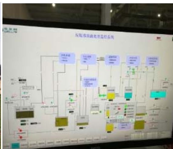
渗滤液废水处理自动控制
