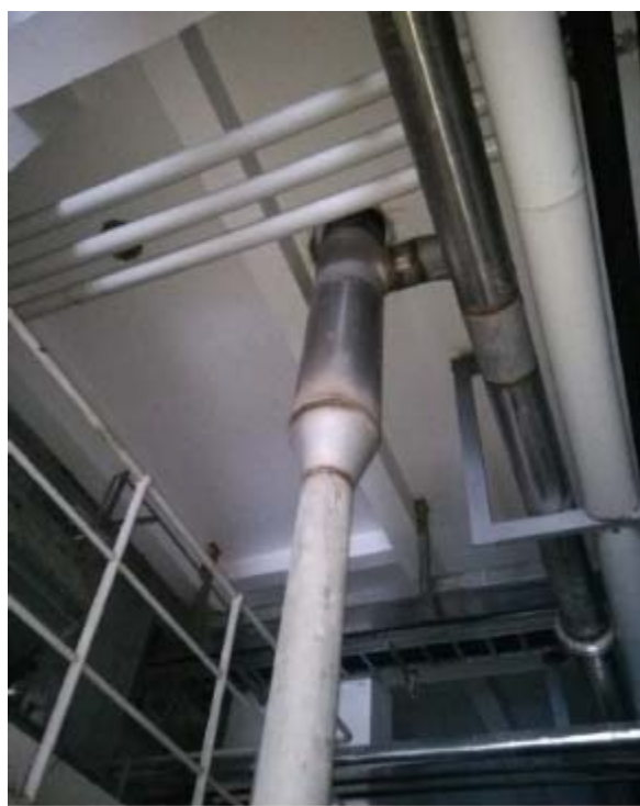
渗滤液收集管道（收集斗下）
