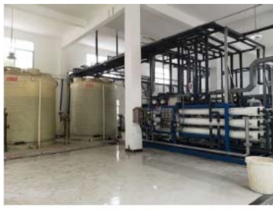
废水处理系统
