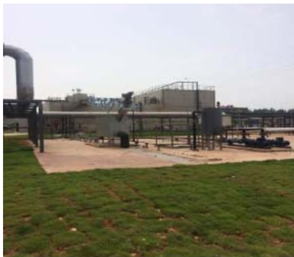
渗滤液废水处理站
