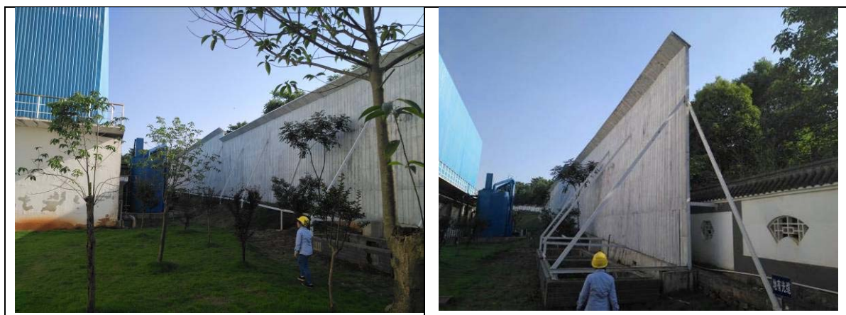
图 6.5-2 类比工程冷却塔西侧隔声屏图片
