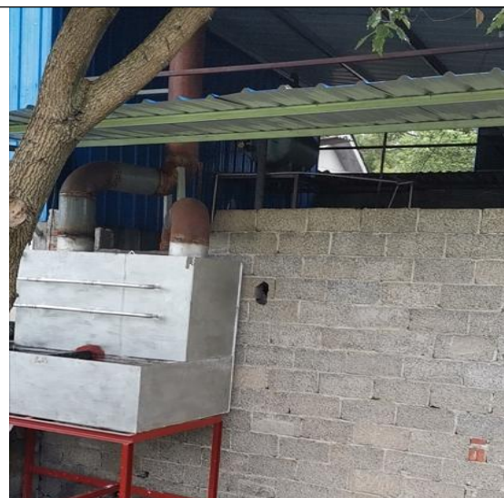
水膜除尘设施
