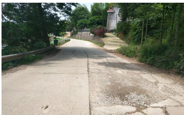
X016 老路路面坑槽
