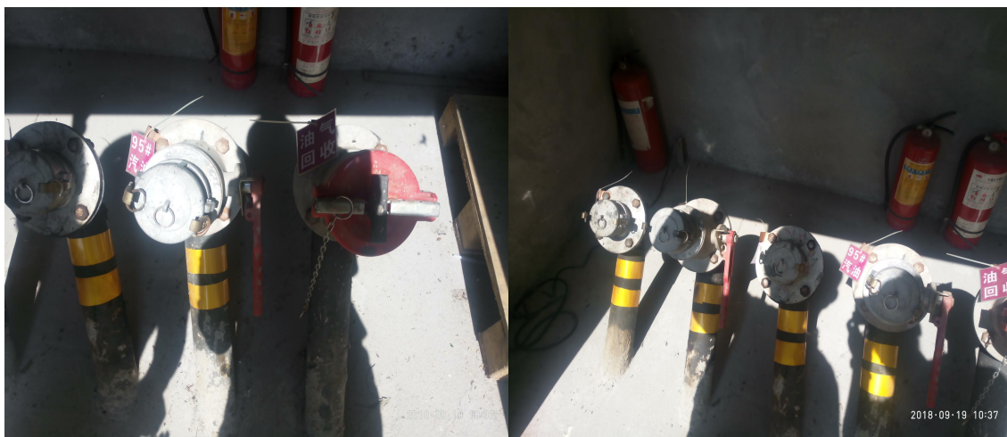
图 4.1-1 油气回收装置现场照片
