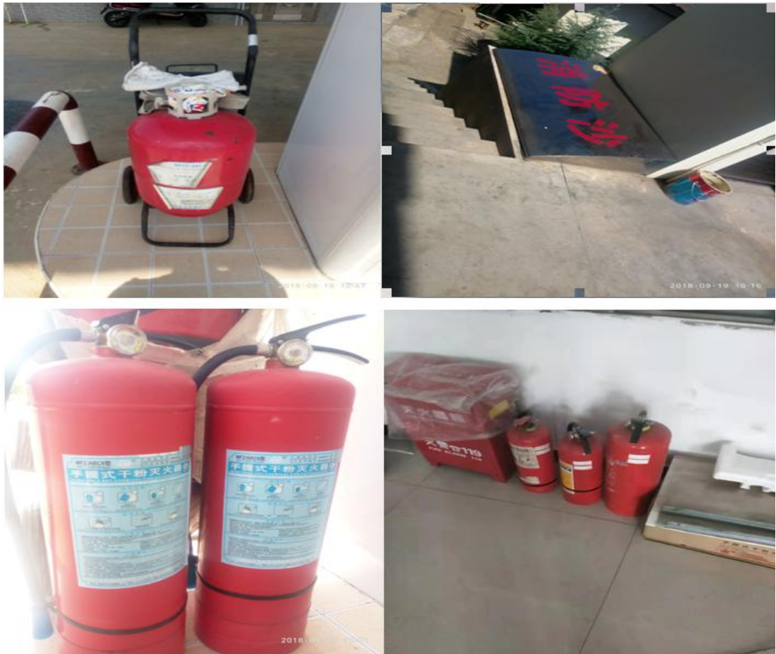
图 4.2-2 加油站消防设施现场照片
