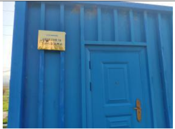
安源镇跃进村柑子园生活污水处理站
