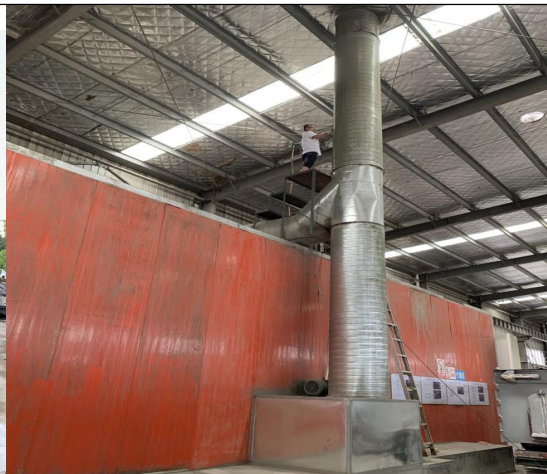
车辆打磨车间废气处理设施
