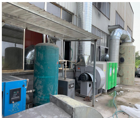
烤漆房和构件喷漆车间废气处理设施
