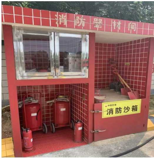
加油站消防设施
