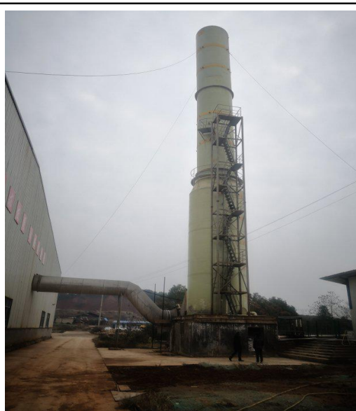
窑炉废气处理设施及排气筒
