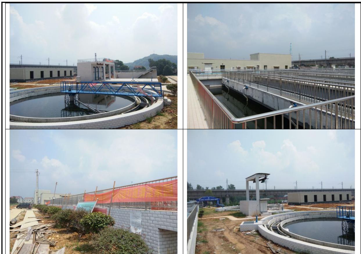
图 2-2 桃江县第二污水处理厂现场照片
