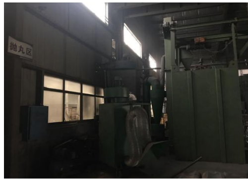
抛丸区集气罩+布袋除尘器
