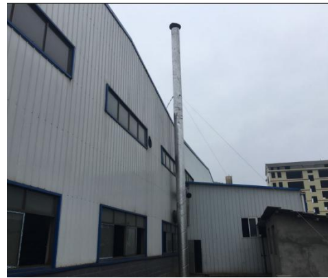
车间有组织废气排气筒
