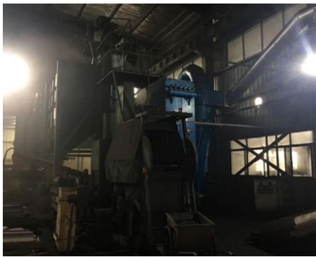
混砂区集气罩+布袋除尘器
