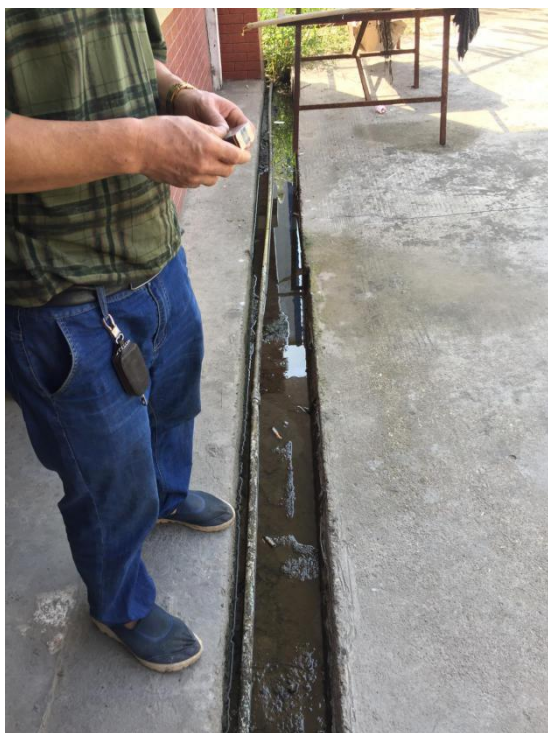
厂区雨水收集沟
