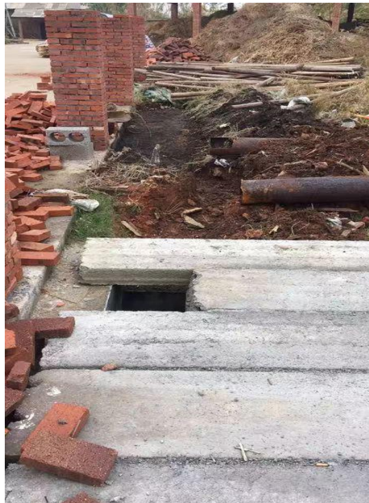
初级雨水收集池
