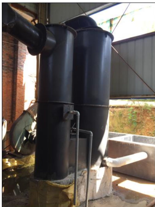
锅炉湿法水膜除尘装置
