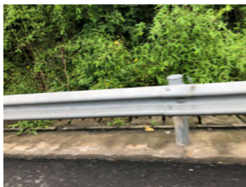
路边雨水收集渠
