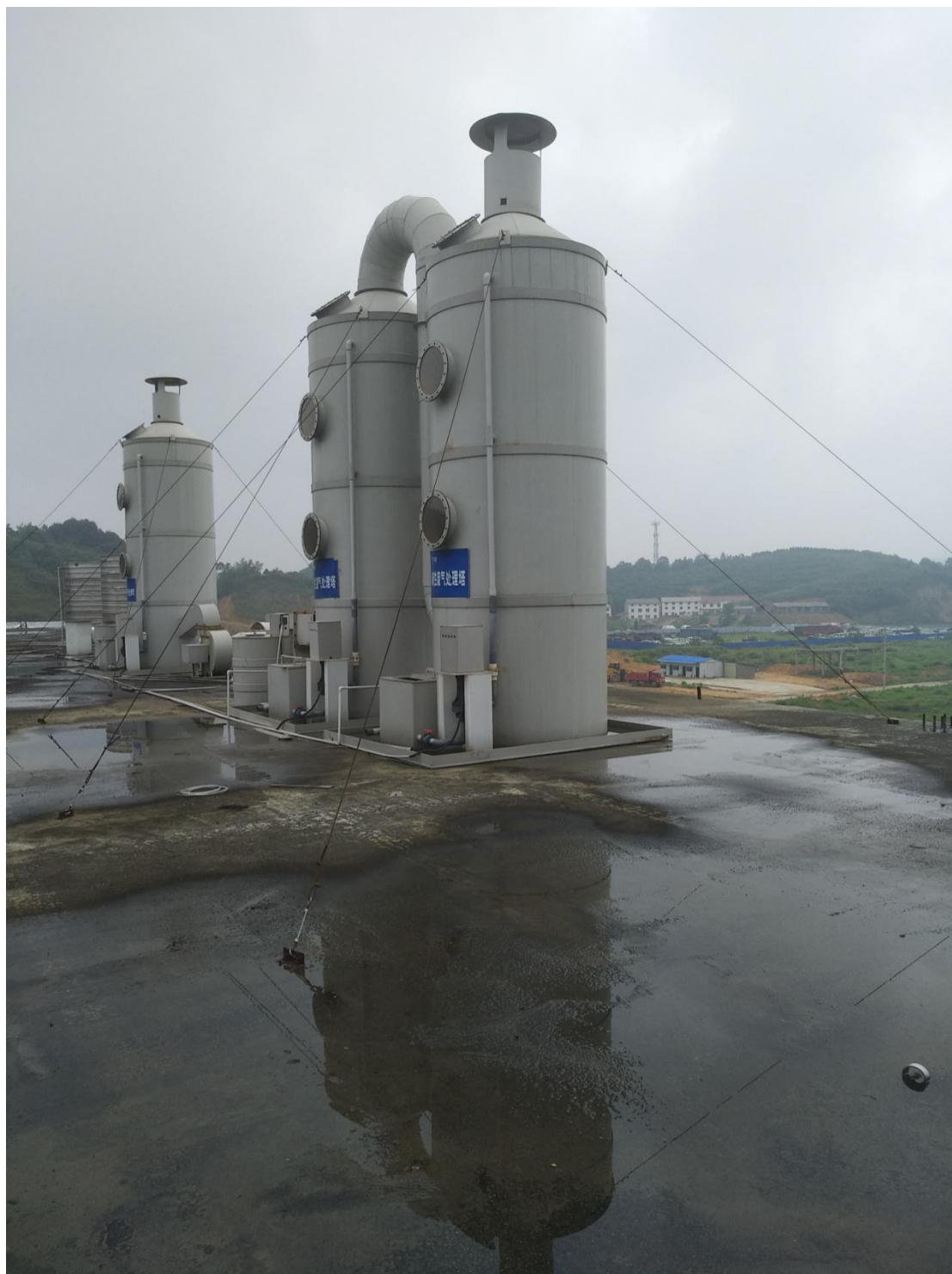
废气处理设施
