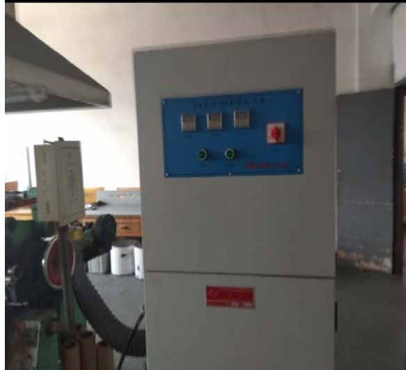
车间除尘设施
