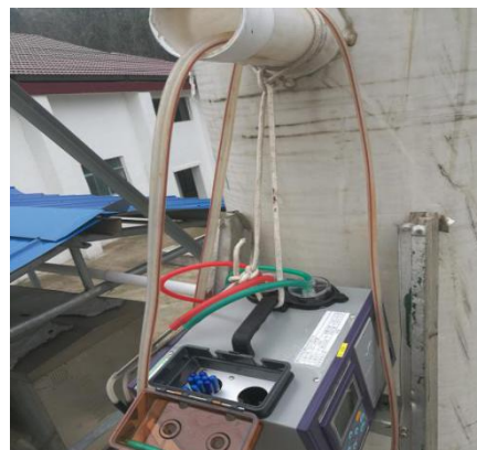
有机溶剂废气排放口
