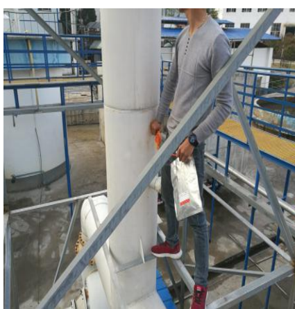
污水处理站恶臭处理设施出口
