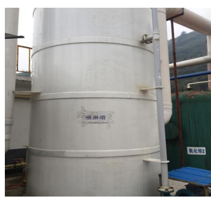
污水处理站废气喷淋塔
