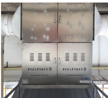
污水处理站废气光氧催化净化器
