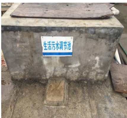
生活污水调节池
