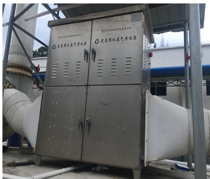
有机溶剂废气处理设施
