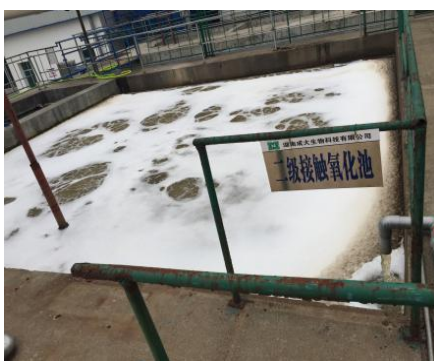
二级接触氧化池
