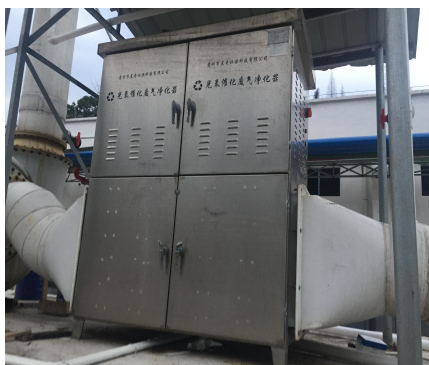
有机溶剂废气处理设施
