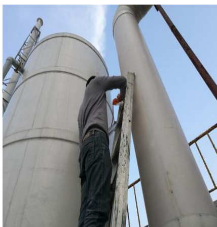
污水处理站恶臭处理设施进口
