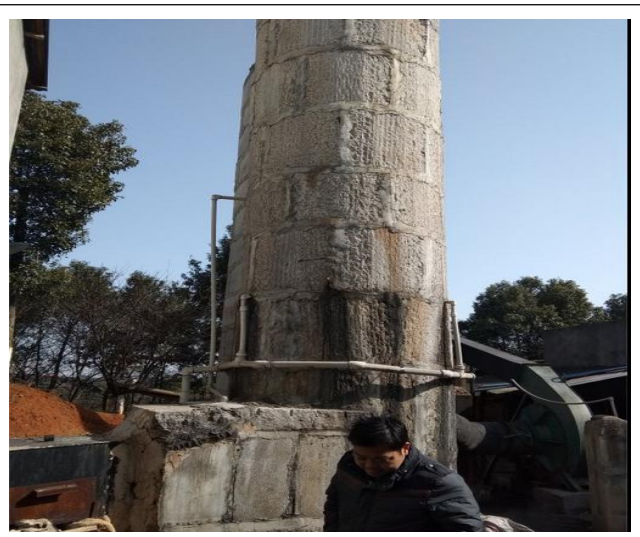
锅炉废气麻石水幕除尘设施
