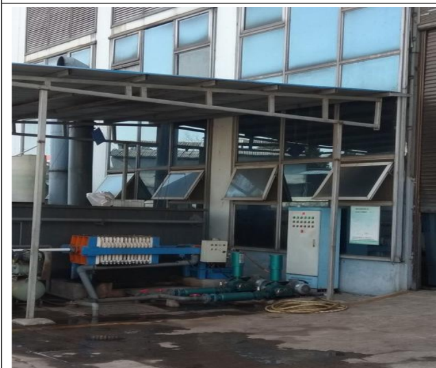
厂内污水处理设施
